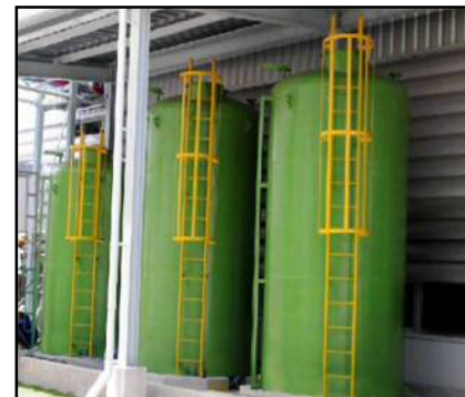
玻璃钢槽罐 FRP TANK
